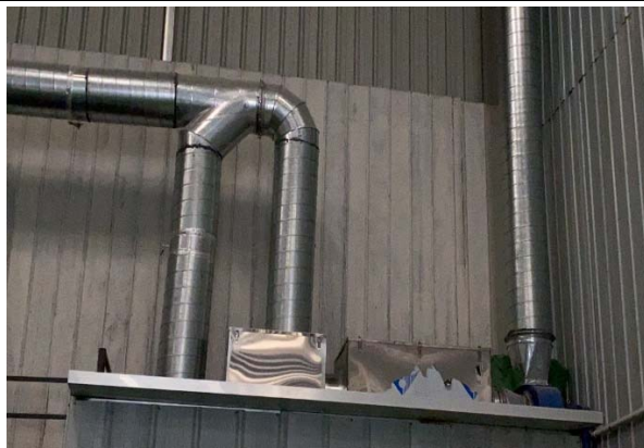
有机废气处理设施（两级活性炭）
